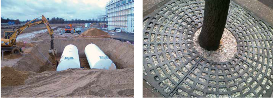
Şekil 3. Yüzey altı yağmur tankları ve karbon ve kum filtreleri (Poneke, 2022)
