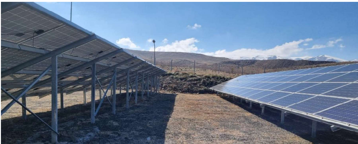
Şekil 3. Iğdır Üniversitesi PV enerji üretim sahası, sabit panel sistemi.
