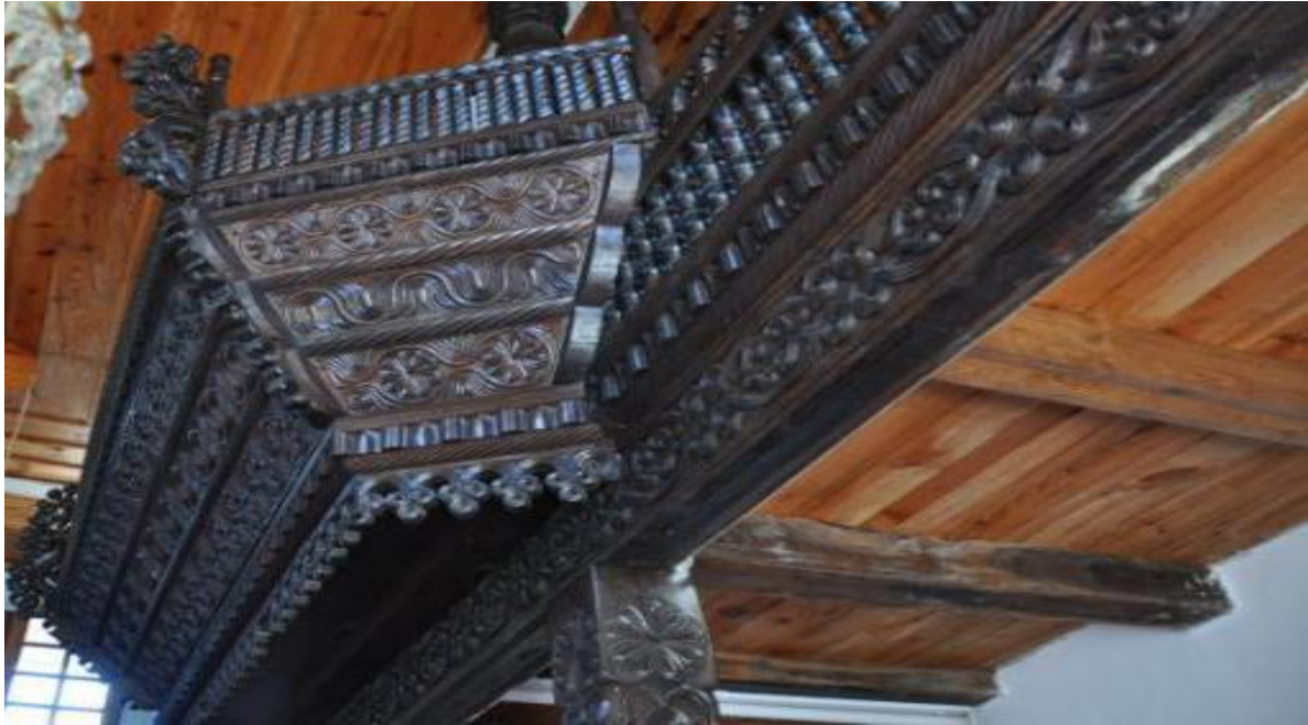
Resim12. Of, Bölümlü Mithatpaşa Camii Mahvil Köşkü Korkulukve Kolonlarındaki Ahşap Dokular
